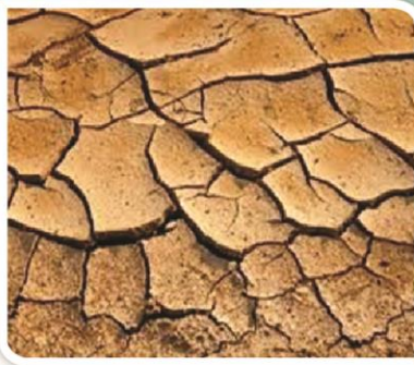
تشکیل ترک‌های عمیق ناشی از تابش آفتاب و خشک شدن مناسب کف استخر
