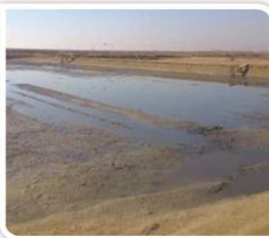
باقی ماندن آب استخر پرورش بعد از تخلیه بدلیل عدم وجود شیب مناسب
